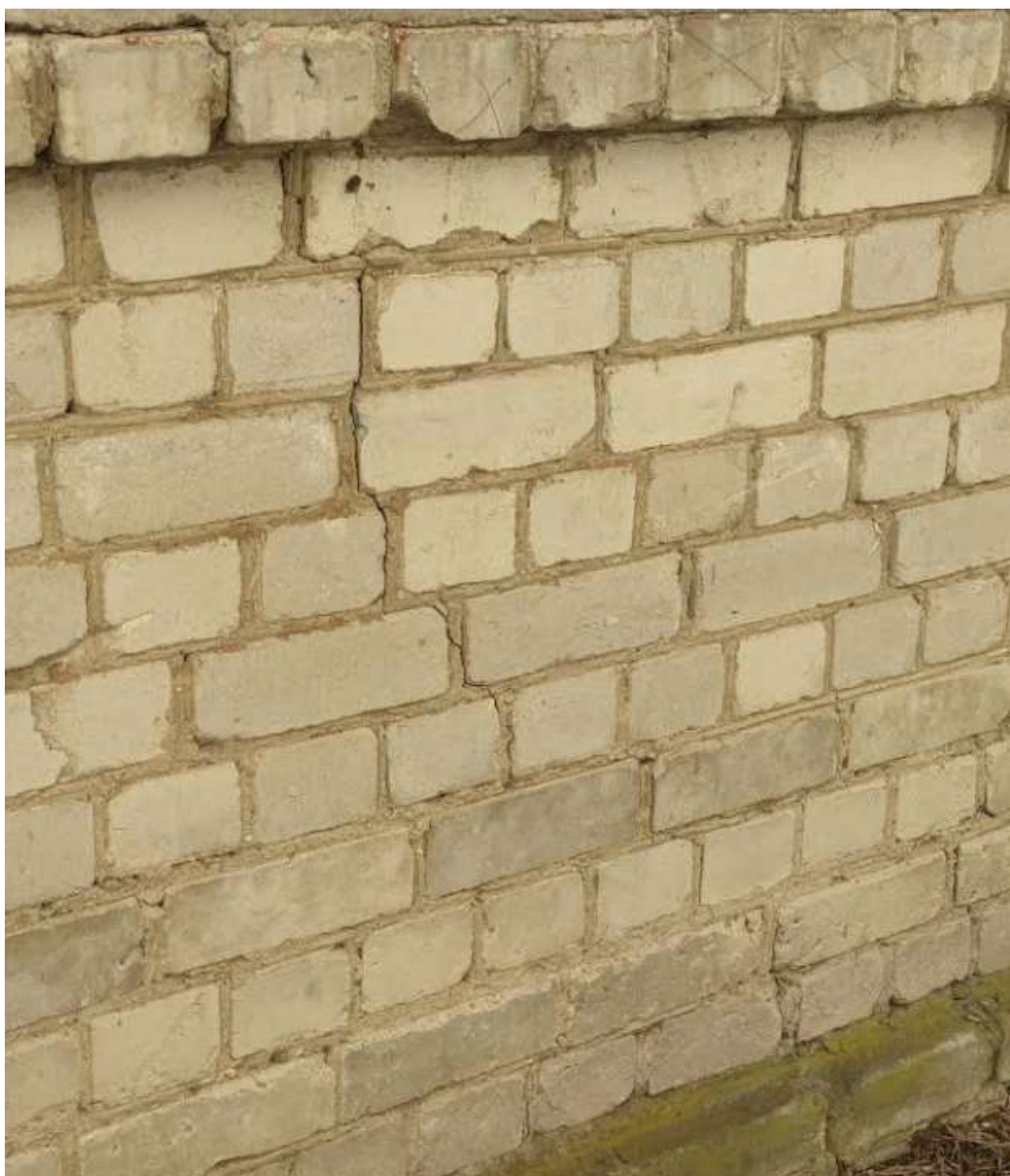
5 pav. Konstrukcijų judėjimo defektai
