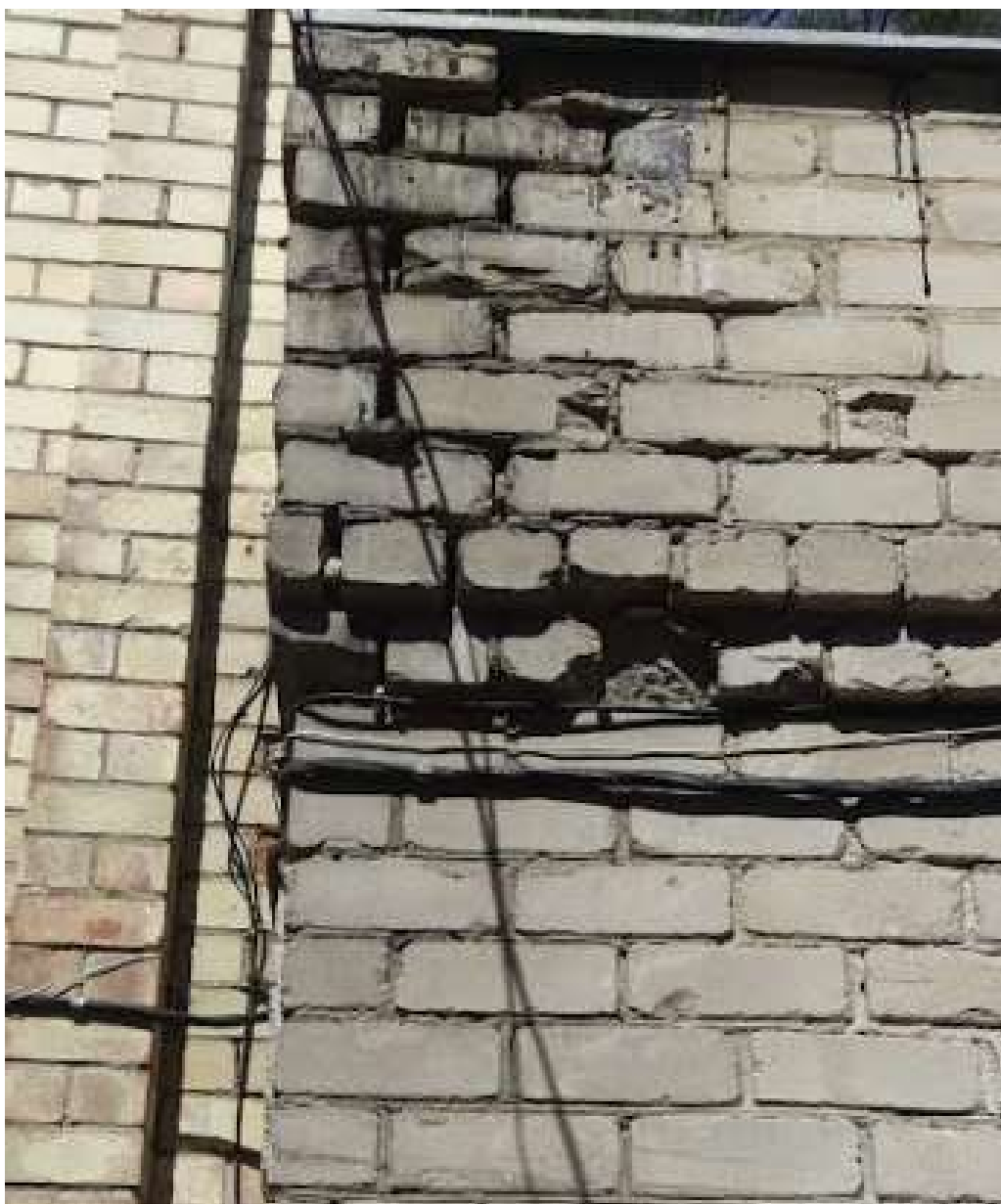
6 pav. Netinkamo vandens nuvedimo sistemų defektai mūriui
