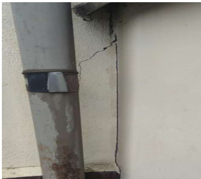
4 pav. Struktūrinis įtrūkimas
