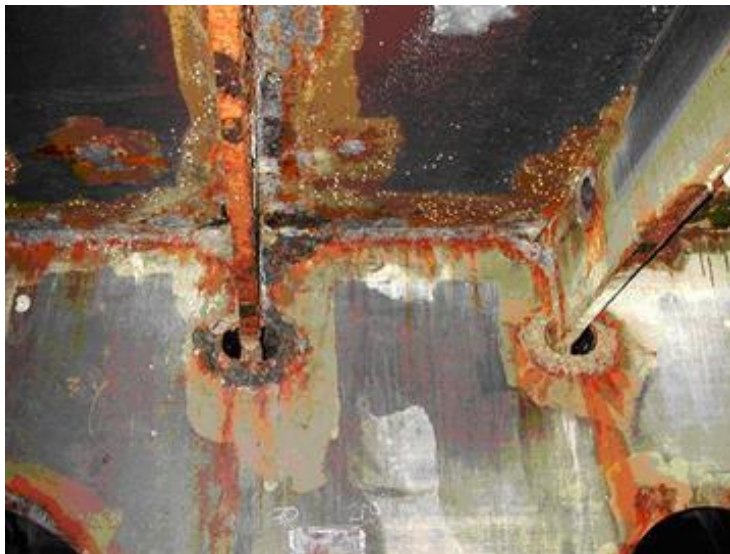
31 pav. Rimtas korozijos padidėjimas tarp pagrindinio denio sijos ir išilginių skersinių sujungimų[1]
