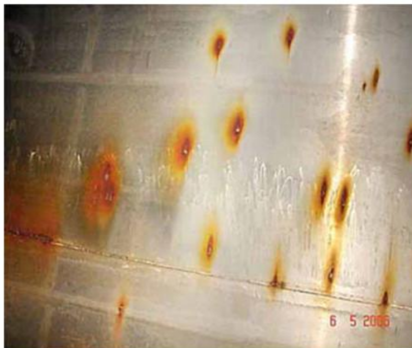
13 pav. Vietinė korozija balastiniame tanke[6]
