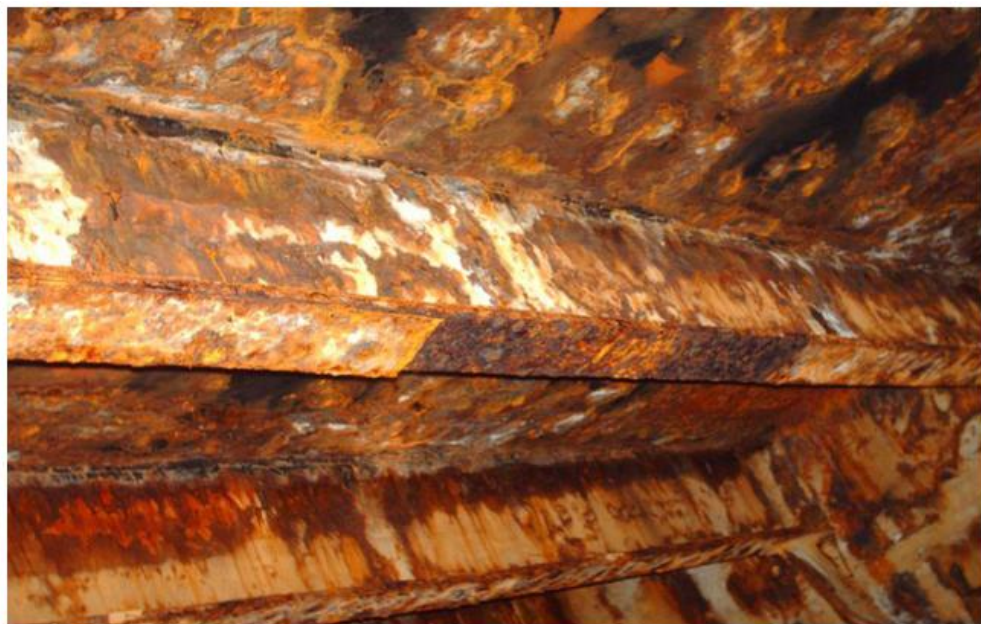
12 pav. Ištisinė korozija balastiniame tanke
