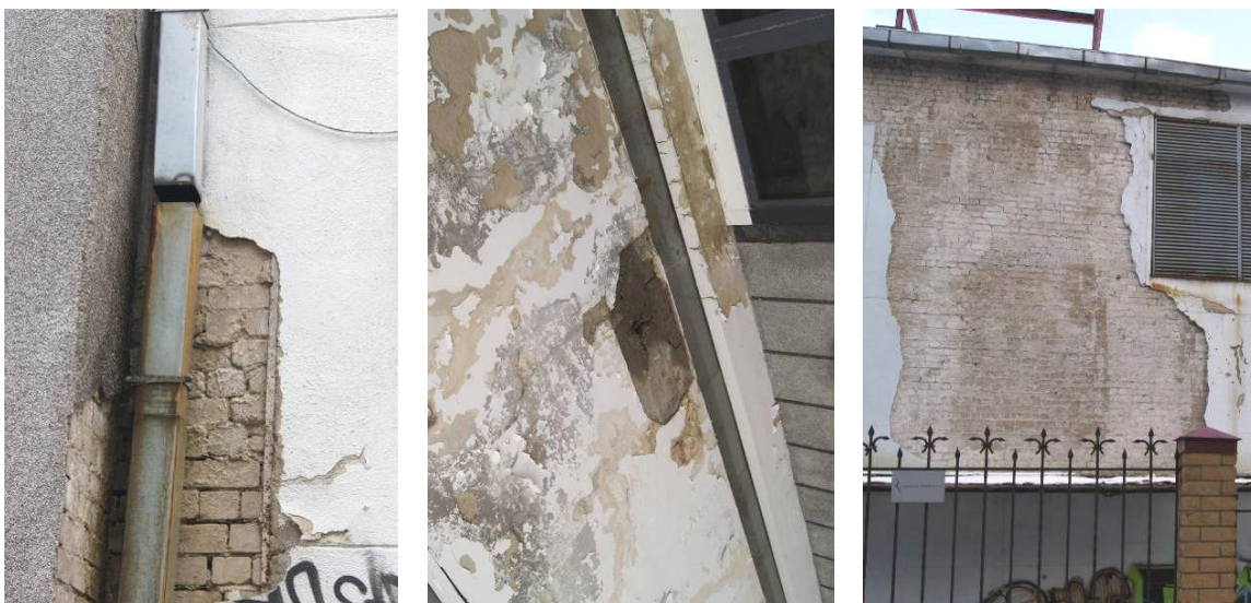
4.6 pav. Kino teatro konstrukcijų defektų fotofiksacija (autorės nuotr. 2011 m. sausio mėn.)
