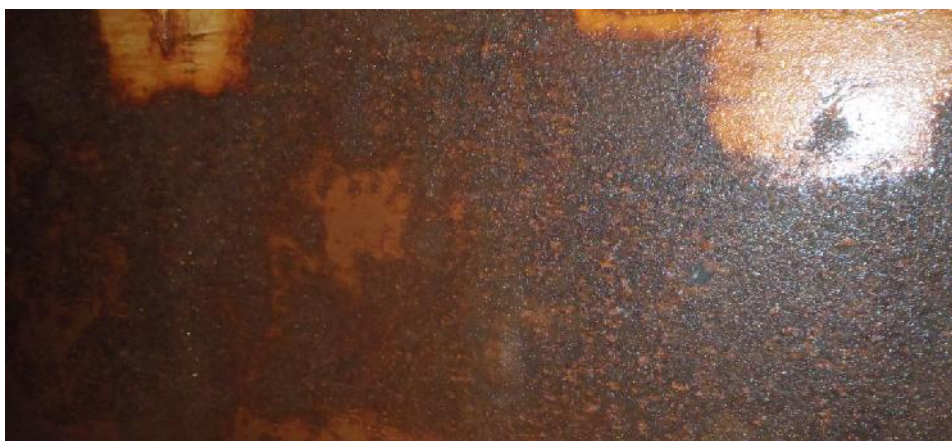
33 pav. Nuotraukoje matomas laivo "Grampian Falcon" kairiojo borto dešimtojo tanko išilginės pertvaros korozinis nusidėvėjimas [ UAB "Harbort Klaipėda" archyvas]
