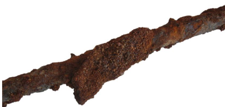
36 pav. Korozijos produktai inkarinio varžto vidurinėje dalyje
