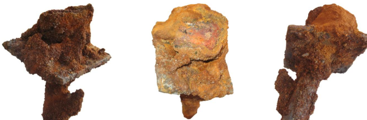
35 pav. Korozijos produktai inkarinio varžto viršutinėje dalyje
