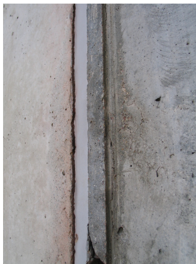
36 pav. Betonavimo nelygumai gelžbetoninėse sienose
