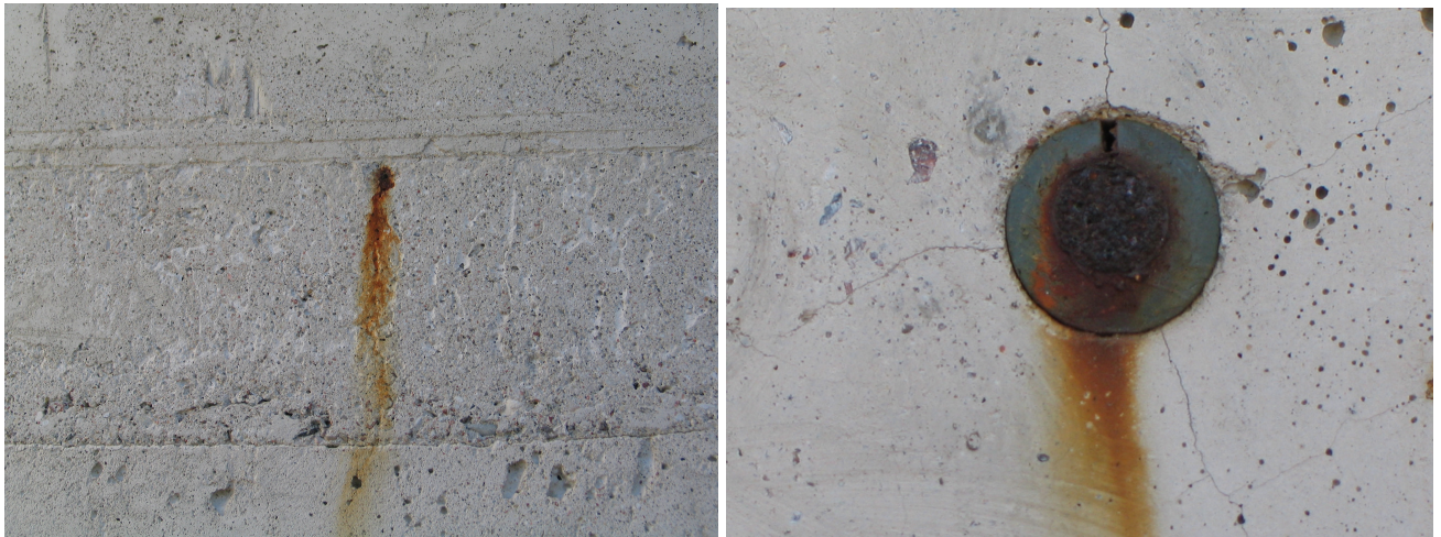
3 pav. Neapsaugotas nuo korozijos plienas betono paviršiuje
