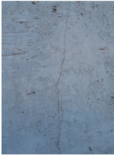
13 pav. Atsivėręs vertikalus plyšys pastato sienoje
