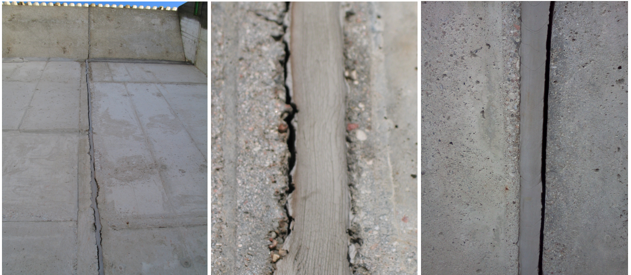
11 pav. Deformacinės sienų siūlės praradusios sandarumą
