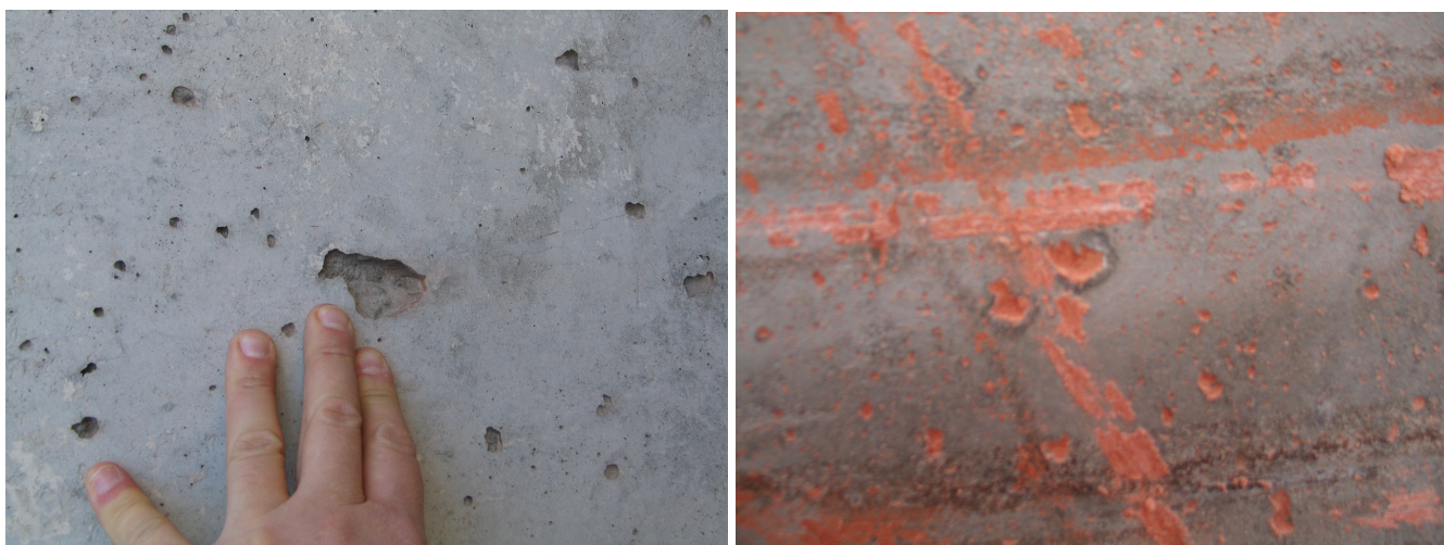
10 pav. Ant gelžbetoninių sienų susidariusios kavernos
