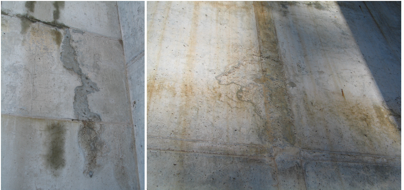
12 pav. Blogai sutankintas betonas išorinėje pastato sienos pusėje
