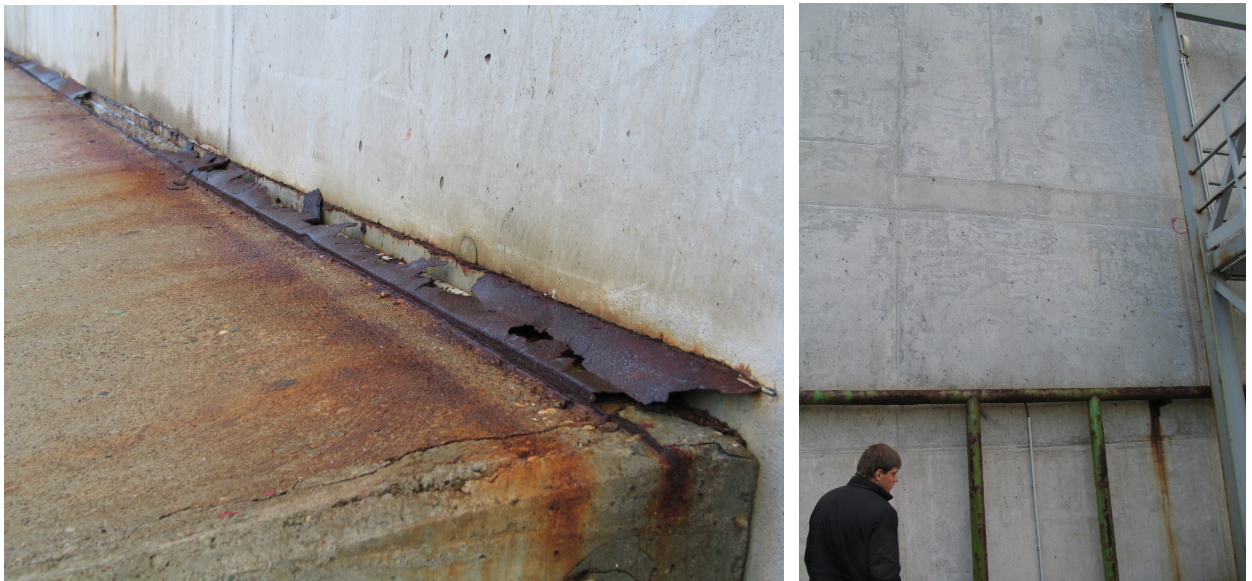
20 pav. Intensyvi plieno korozija išorinėje pastato pusėje
