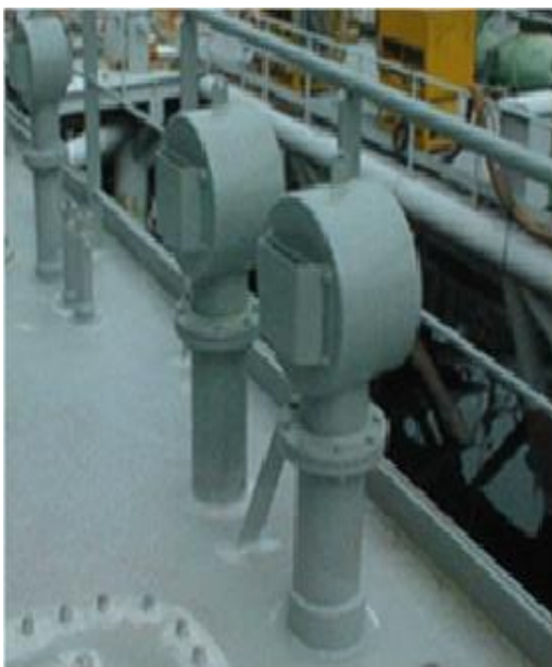
21 pav. Ventiliacijos vamzdžiai.
