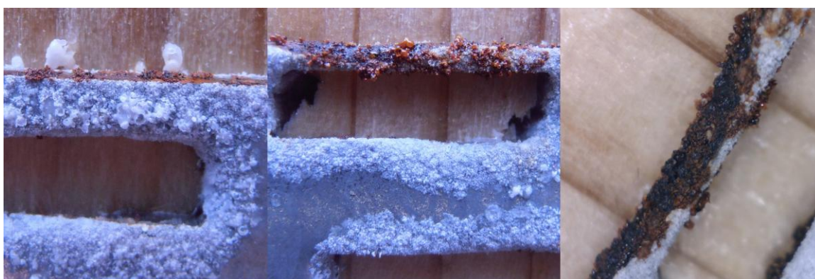
38 pav. Plieno korozija plokštelių briaunose
