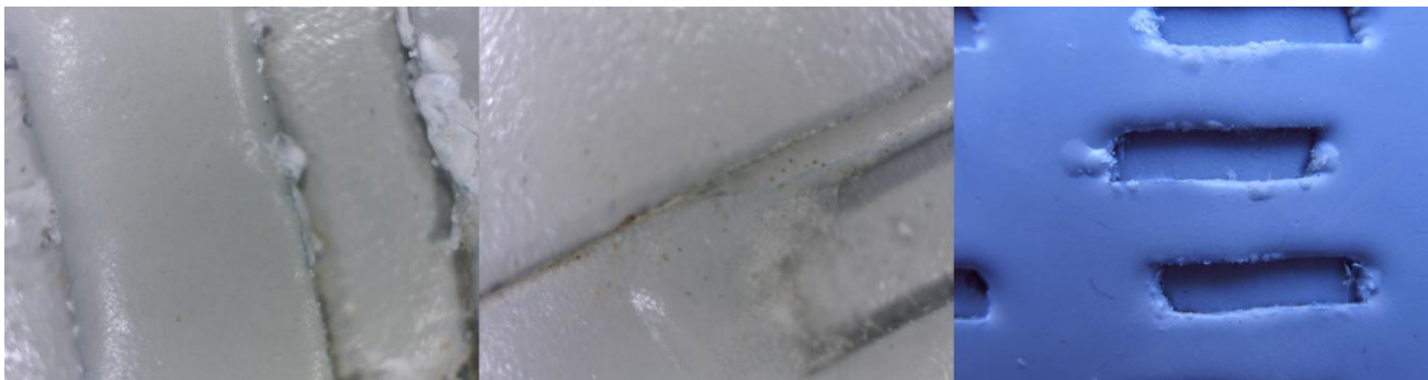
42 pav. Cinko korozijos produktai ant bandinio, apsaugoto epoksidiniu gruntu „EOPRIM“
