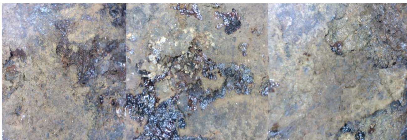
59 pav. Pirmojo kilio strypo korozija ties strypo galu
