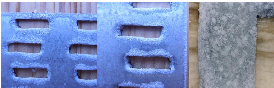
37 pav. Cinko korozija
