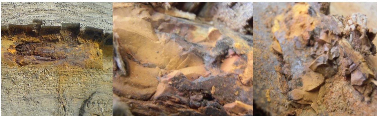
61 pav. Strypas paveiktas tarpkristalinės korozijos
