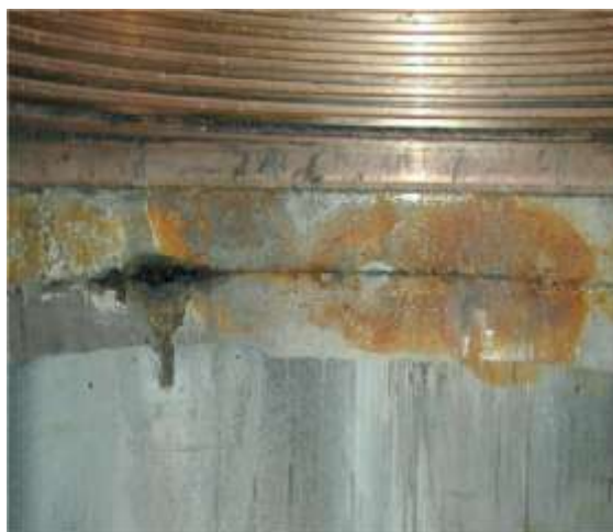
2 pav. Naftos vamzdinių plyšinė korozija.
