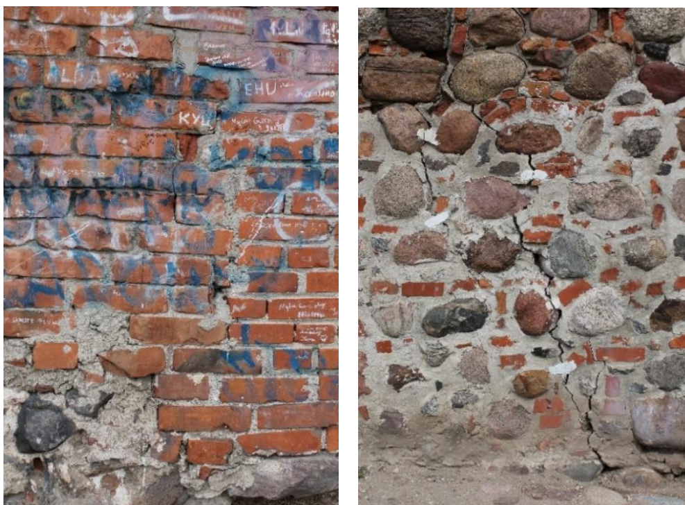
19 pav. Kairėje: plyšys, esantis rytinės Kunigaikščių rūmų sienos pietinėje dalyje; dešinėje: plyšys esantis pietinėje Kunigaikščių rūmų sienoje (fotografuota autoriaus 2016)
