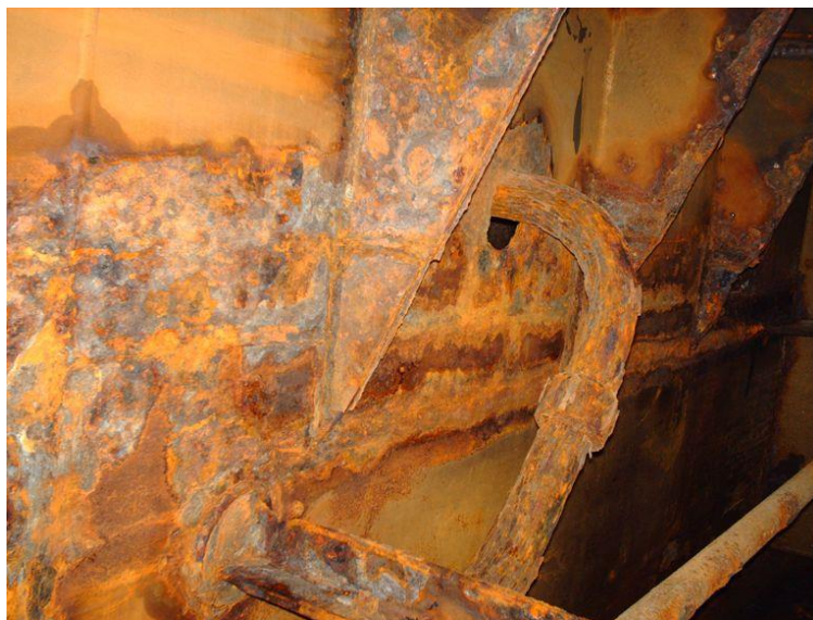
5 pav. Ištisinė korozija balastiniame tanke, laivas eksploatuojamas 25 metus [32]
