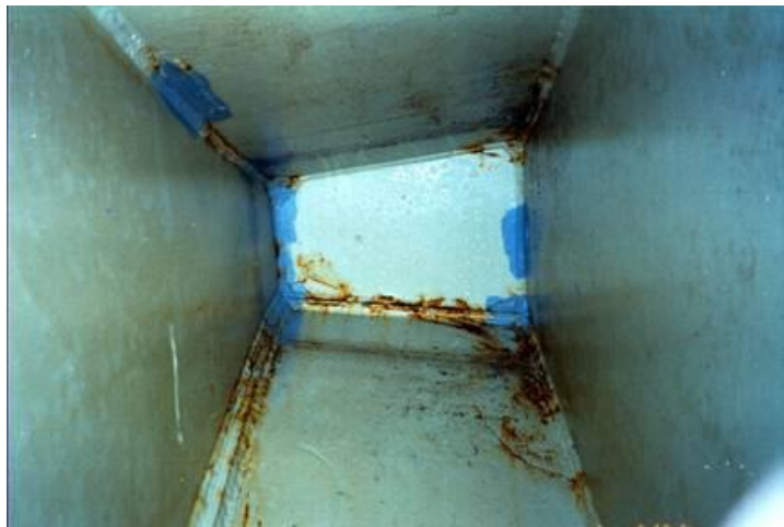
28 pav. Suvirinimo siūlės korozija [3]
