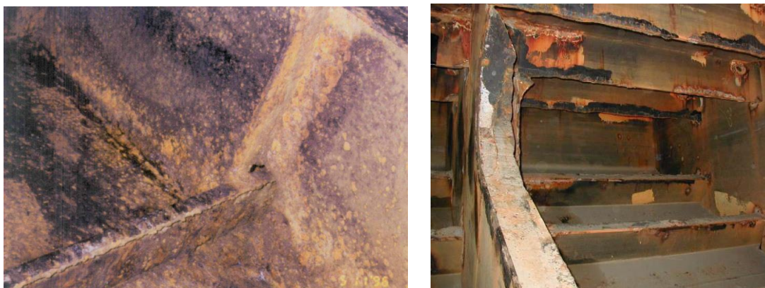
15 pav. Balastinio vandens tankas prastos būklės (paveikta korozijos) [17] [32]
