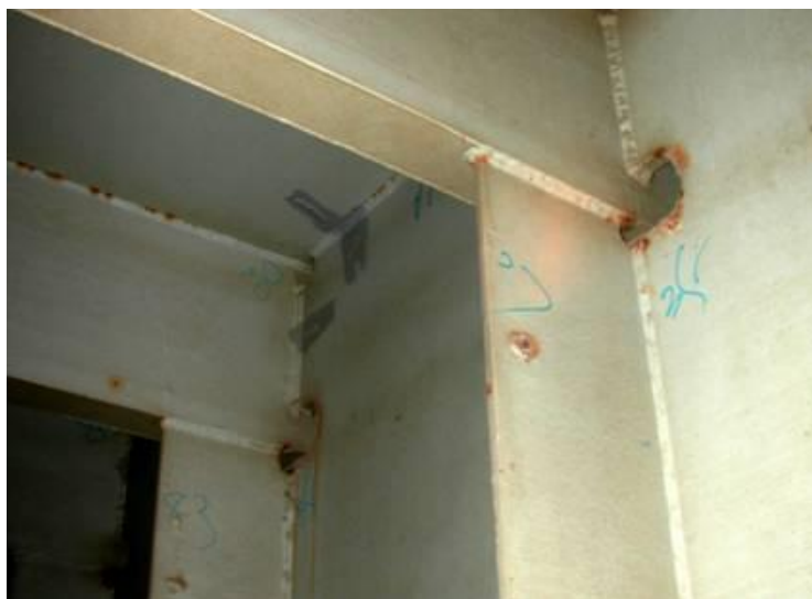
32 pav. Nuo įtempimų koncentracijos atsiradusi korozija ties angomis [37]
