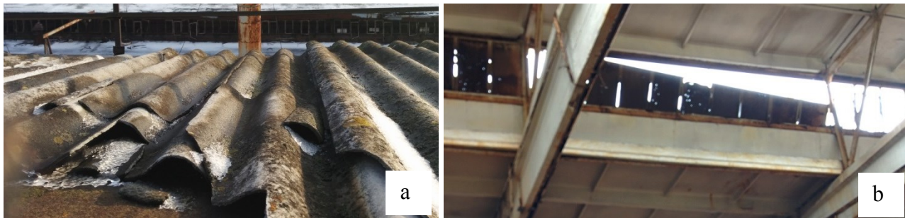
3.21 pav. Pažeista stogo danga: a) triaukščiuose korpusuose; b) vienaaukščiame korpuse
