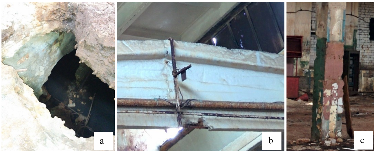
3.18 pav. Vienaukščio pastato korpuso pažaidos: a) anga į rūšį; b) gelžbetoninė sija; c) gelžbetoninė kolona
