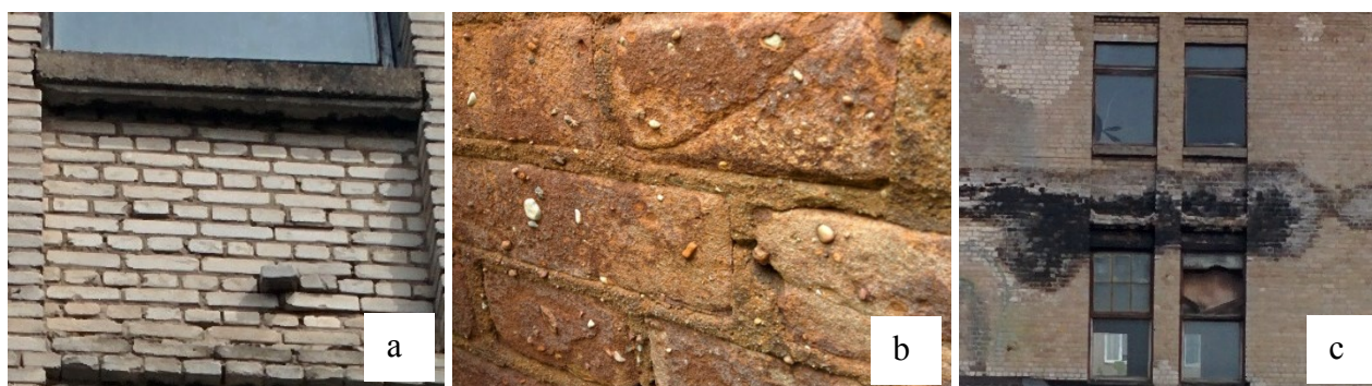
3.20 pav. Išorinių sienų pažeidos: a) siūlių dūlėjimas; b) plytų sandara; c) pelėsio žymės
